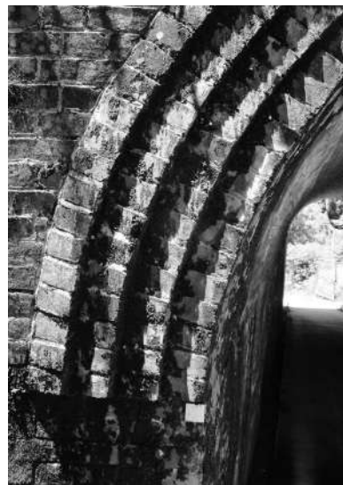
■アーチ部の端面がそろっていないのが斜橋であることのひとつの証である
