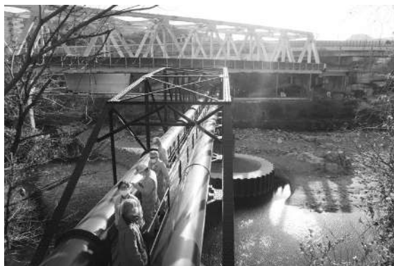
■武庫川第3水管橋(JR宝塚線との交差)
