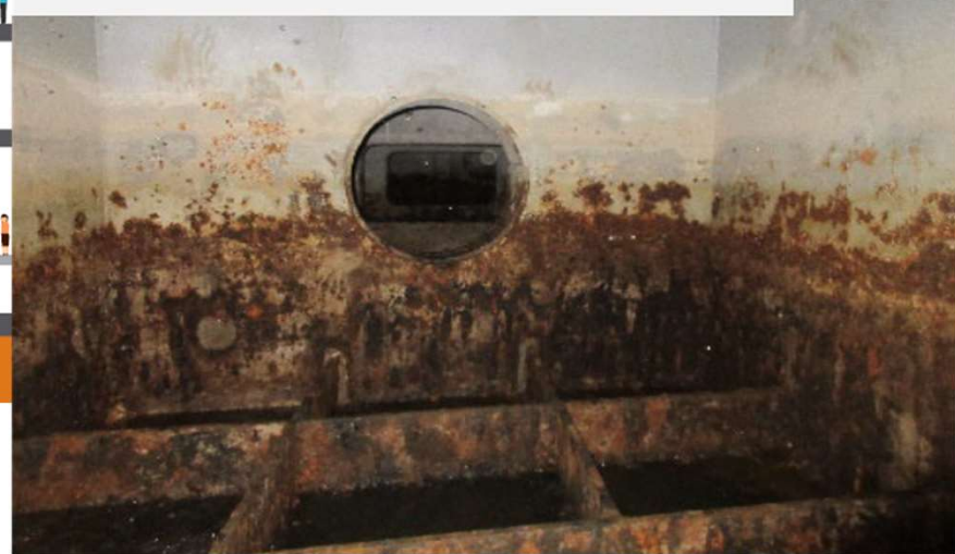
鋼製基礎内部の腐食状況
