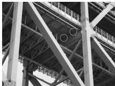
■港大橋における「対震」補強の例① すべり免震支承
