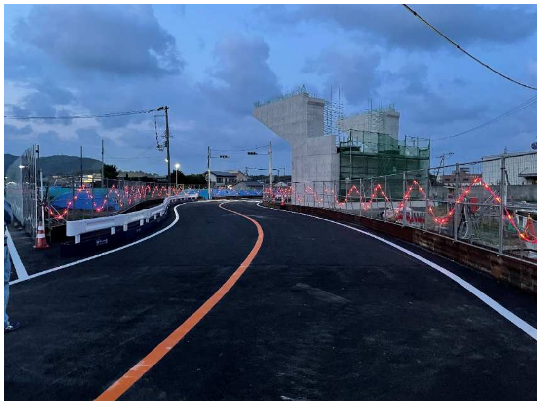
〔夜間照明の配置状況〕
