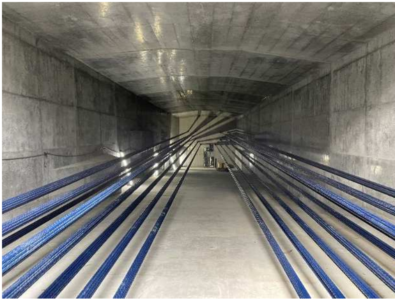
〔箱桁内の外ケーブル配置状況〕
