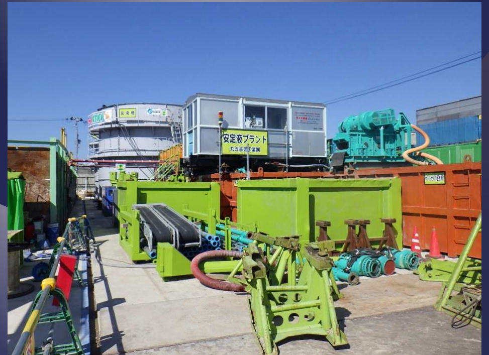
安定液プラント
