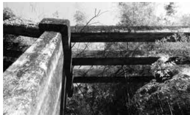
下古沢地区の廃高架橋
