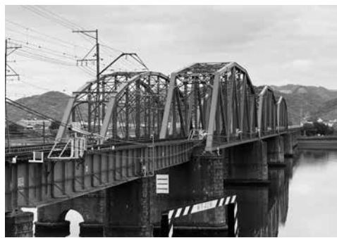
■左側が明治期に架設の上り線でピン結合のトラス構造。右側の下り線は大正期に架設のワーレントラス構造。上り線の橋脚部には「削り貫き」が施されている。
