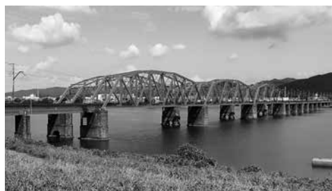
■紀ノ川橋梁の全景。紀の川に架かる美しいフォルム。百年を超える橋梁の維持管理対策に期待が寄せられる。
