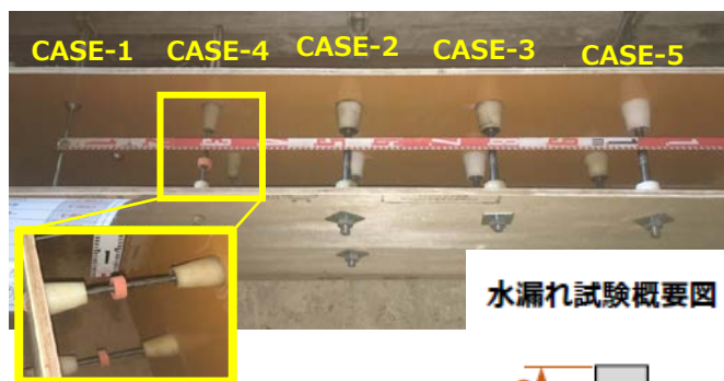
セパレーター種類とPコン処理の漏水
