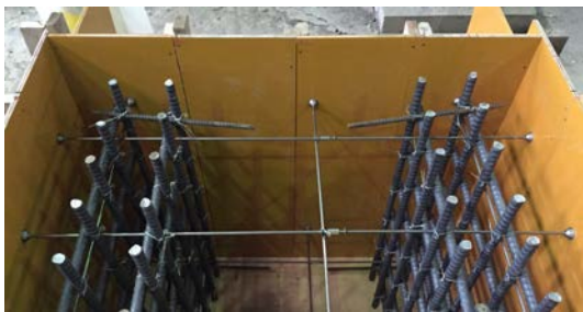
型枠の隙間からのペースト漏れ
