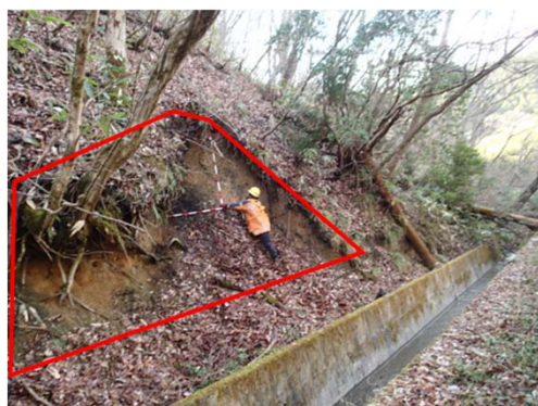
溪岸斜面の崩壊
