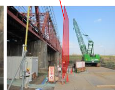
クレーン作業安全対策
