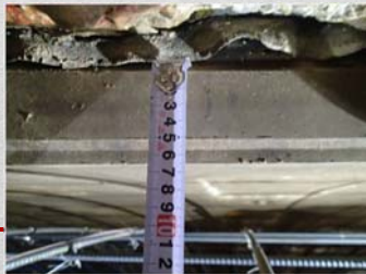
シール材が露出する剥離
