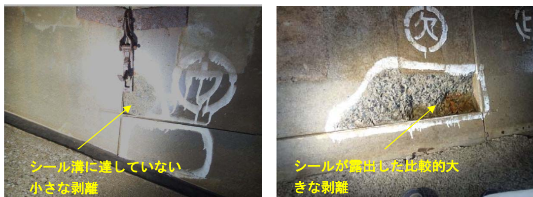
図-3.2.1 シール溝に達していない小さな剥離とシールが露出した大きな剥離 1)
