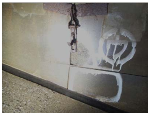
比較的浅い軽微な剥離
