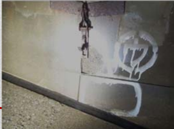
比較的浅い軽微な剥離
