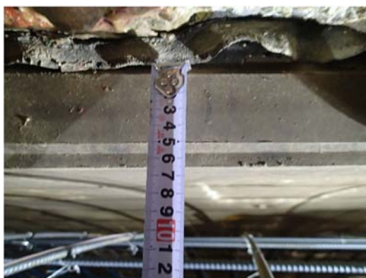
シール材が露出する剥離
