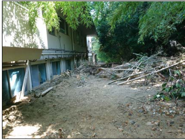
P1 谷出口の家屋で土砂受け止め。層厚約1m
