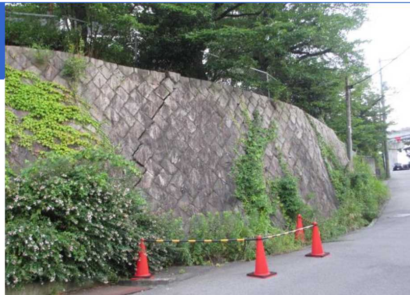
ブロック積み擁壁被害
