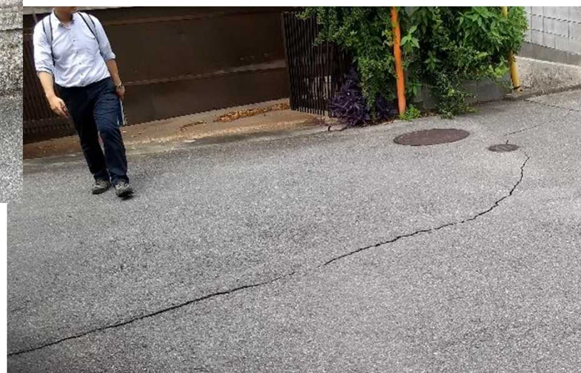
被災擁壁上部亀裂(幅2cm)
