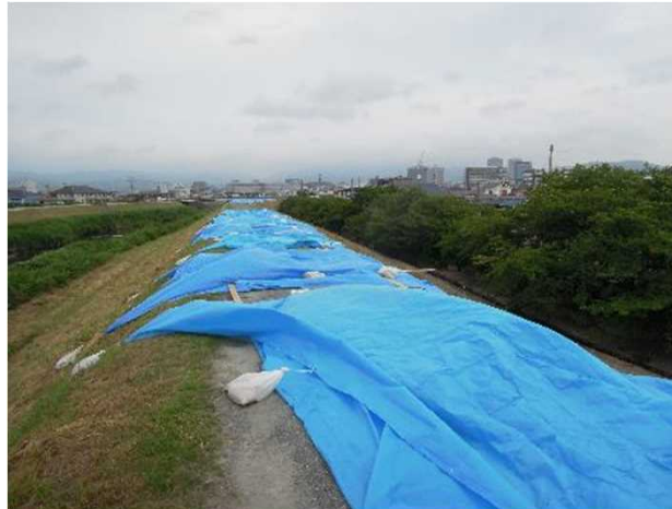
堤体の縦断亀裂が300m程 連続している状態
