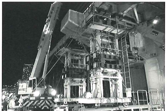
■軌条設備上に自走式油圧ジャッキ架台を組み立て、切断したRC橋脚梁ブロックを空頭制限を受けない桁外側まで引き出している状況
