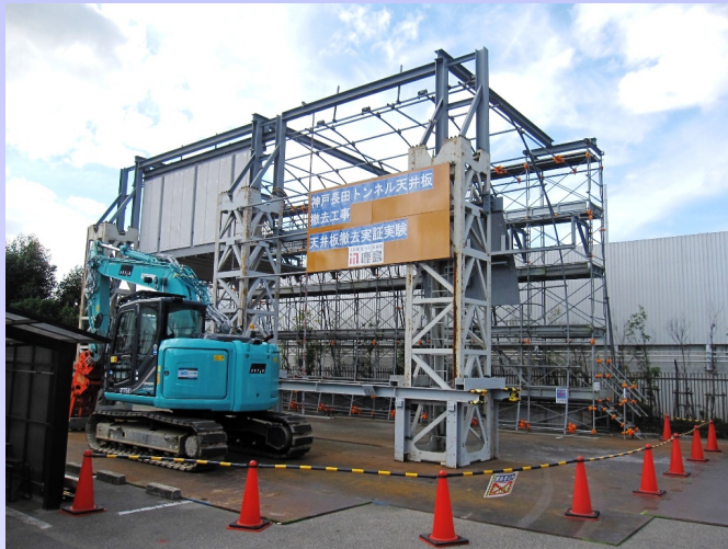
実証実験設備 全景
