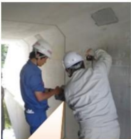
鉄筋探査機器の使用実習状況 別途、ファイバースコープによる空洞探査も可能(壁面をコア抜き)
