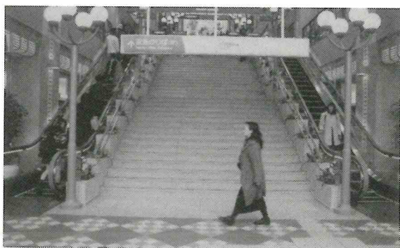
■写真3-6 1階エスカレータ（阪急伊丹駅）
