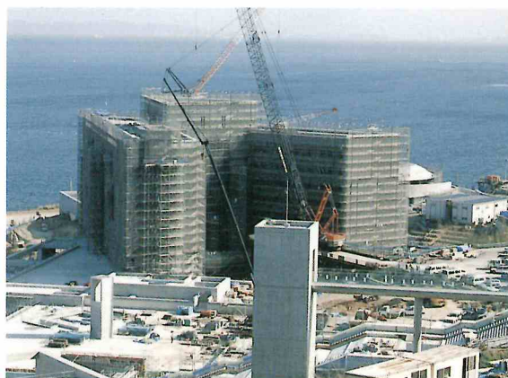
「リゾート&コンファレンス」を基本コンセプトに201の客室を持つホテル
