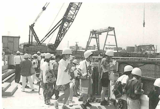
住之江抽水所(円形ポンプ場の上から底を眺めています)
