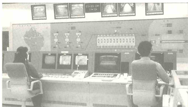
中央制御監視室
