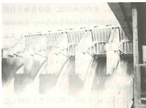
サミュエルダムのスルース・ゲート
