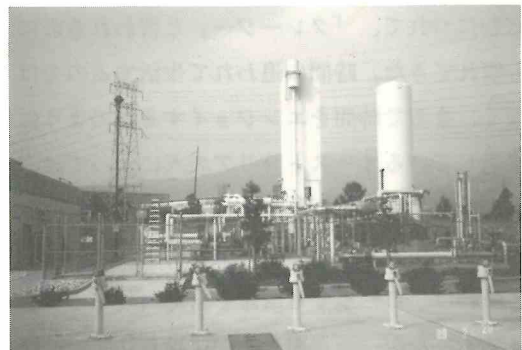
写真1 オゾン発生装置
