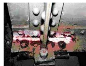
(下フランジき裂)
