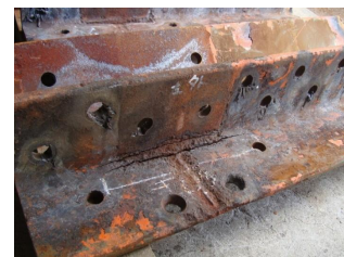
取り出した山形鋼（き裂あり）
