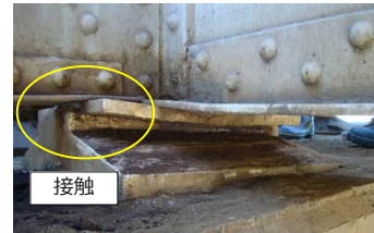
摩耗・変形が進行し、接触した状態
