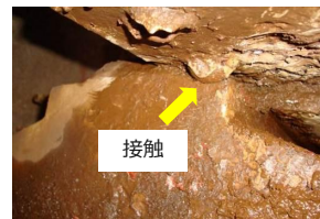
ガセットプレートのリベットが 線支承に食い込んだ例
