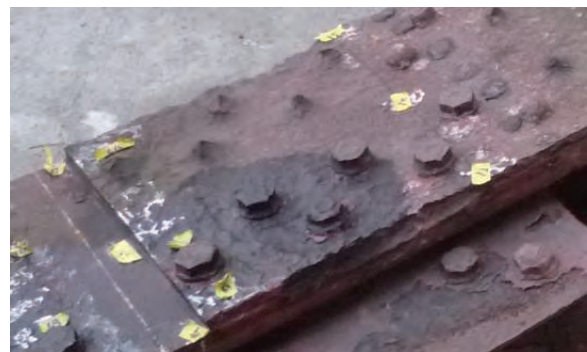
写真-5 d-d 断面の腐食状況
