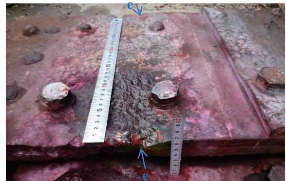
写真-6 e-e 断面の腐食状況
