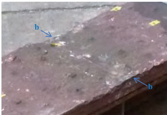
写真-3 b-b 断面の腐食状況
