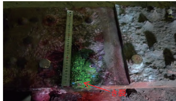
写真10 上部試験体に発生したき裂③(腐食部)
