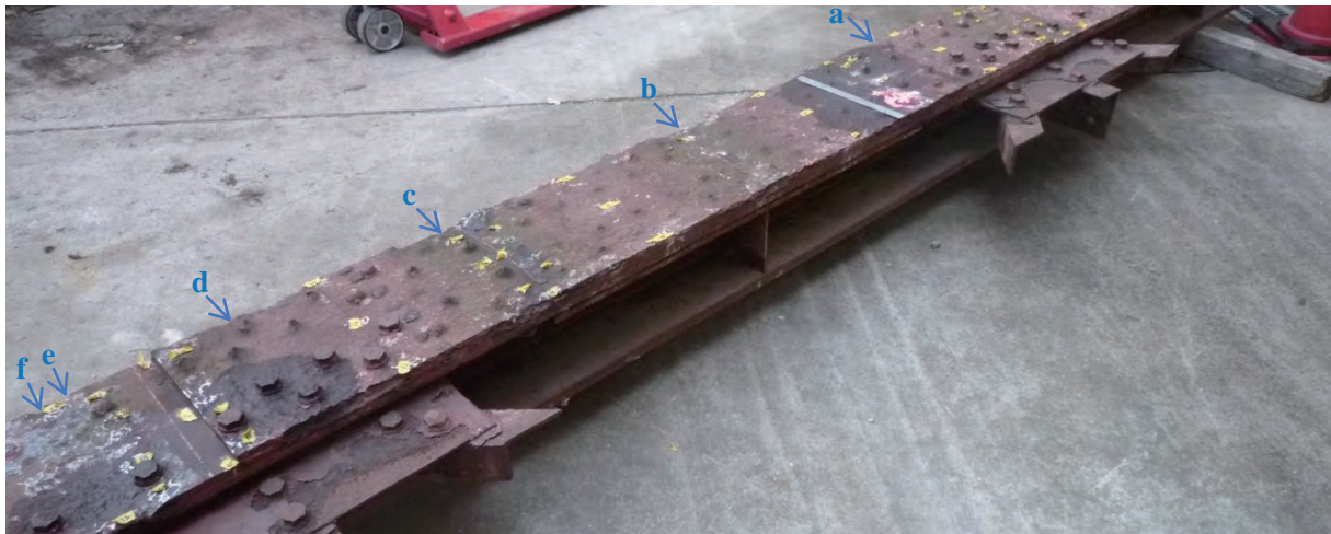
写真-1 添接部の腐食状況
