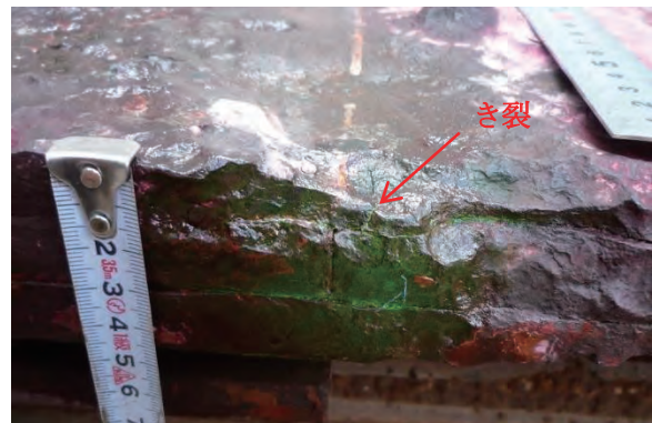
写真9 き裂②海側リベット孔拡大
