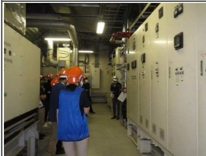
▼ターミナルの電気室でジャッキアップに対応するために配管へ施された工夫等を見学いただきました。
