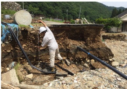
写真19 左岸側迂回流による河岸浸食（公文地区）
