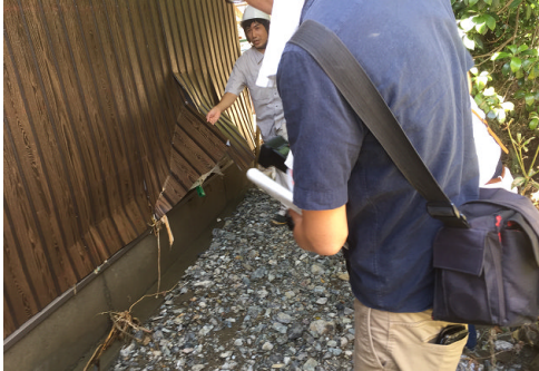
写真2 左岸側家屋の洪水痕跡 (2018.7.13河原田地区)
