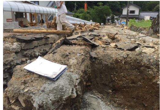
写真5 左岸側迂回流による河川護岸・道路の浸食 (2018.7.13河原田地区)
