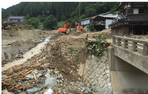
写真10 2河川合流部の洪水痕跡 (2018.7.13河原田地区)
