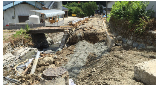
写真4 右岸側迂回流の流下痕跡 (2018.7.13河原田地区)
