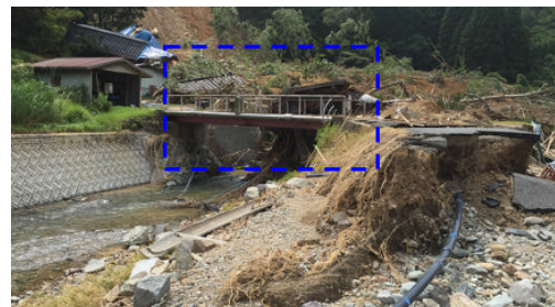
写真17 流木・建材による橋梁閉塞(2018.7.13公文地区)
