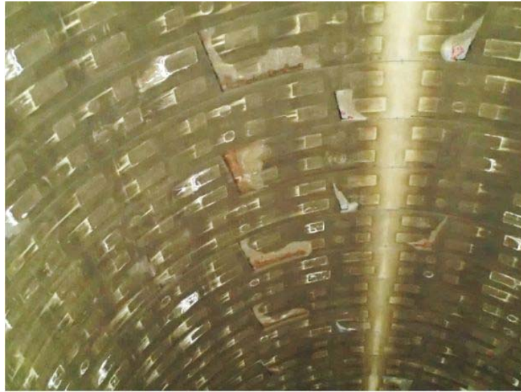
図-3.2.2 外郭第三工区頂部Kセグメントの剥離状況
