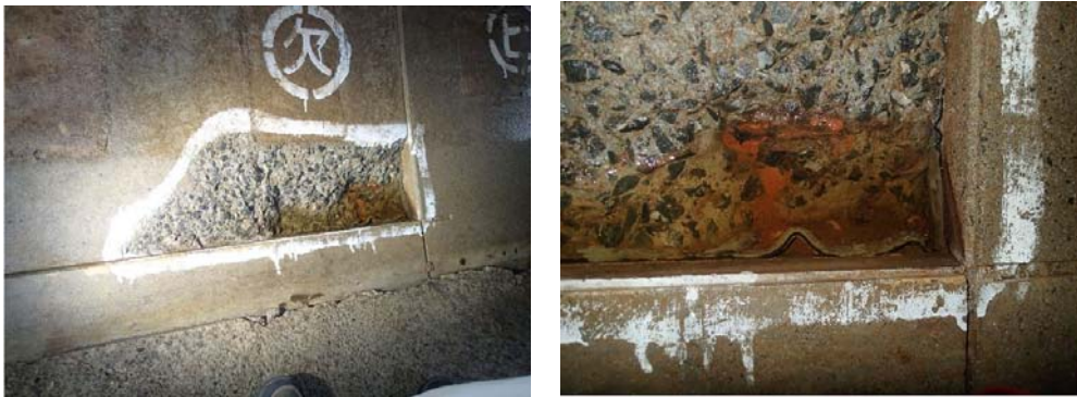
写真-2.1.7 RCセグメント隅角部の剥離（欠損）
