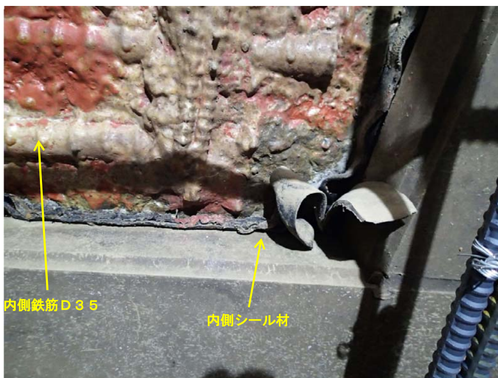
写真-2. 4. 4 剥離損傷状況
