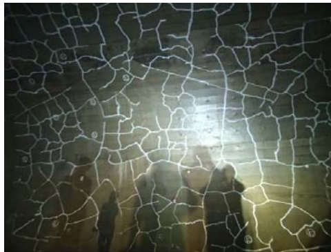
写真-2.1.6 本管の連結管との接合部の反対側の網目状ひび割れ
