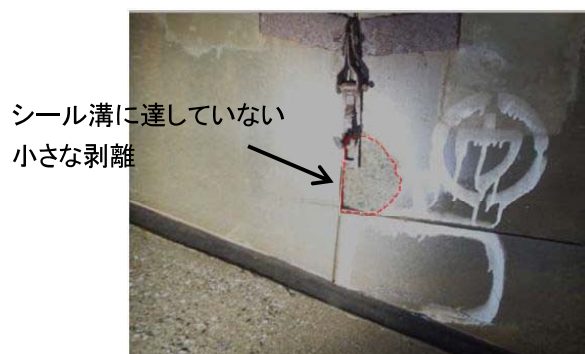
図-4.3.3 シール材に達していない軽微な損傷（神田川・環七地下調節池第Ⅰ期）
