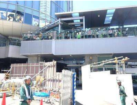
4. 2階のスカイウォークから工事場 所の全体を見てもらい工事の全体像 をつかんでいただきました。
