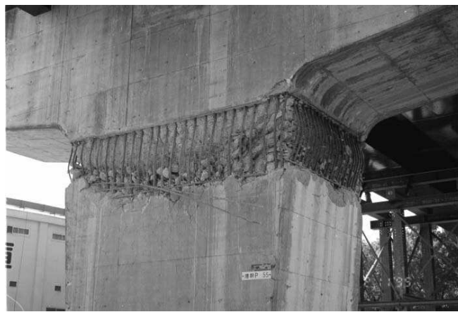
写真2 鉄筋コンクリート橋脚の破壊例
