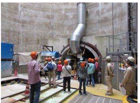
▼立坑下に降りて、トンネルの大きさを体感していただきました。
